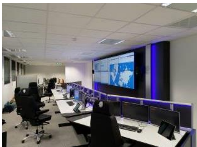
Figura 10: Soluția de monitorizare integrată unică implementată la Strasbourg
